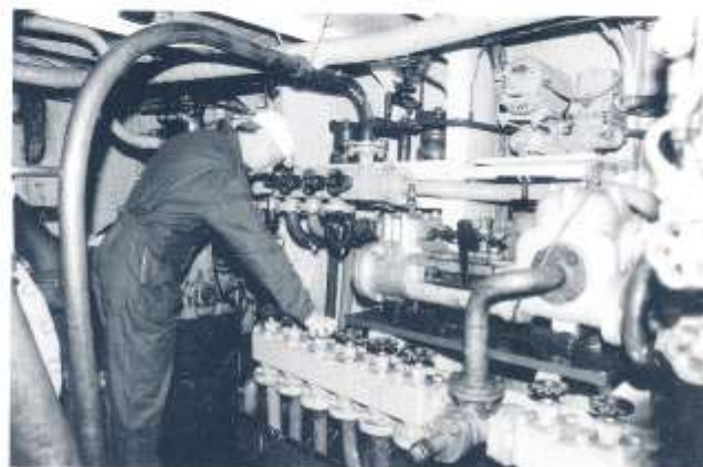
Babordssidan i maskinrummet. Donkeypumpen till höger om mannen.
