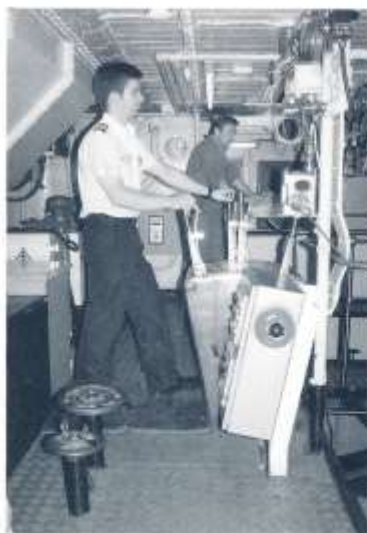
Från manöverplatsen i maskinrummet i WAVERLEY. Det vore intressant om någon läsare kunde säga hur ett maskineri som detta manövreras. Mannen i bakgrunden skriver maskindagboken. Foto Christer Eliasson.
